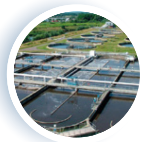
PLANTAS DE TRATAMIENTO DE AGUAS RESIDUALES
